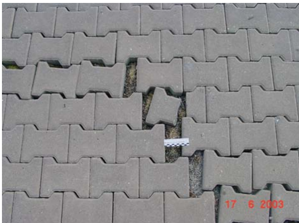
Bild 1 Pflasterverschiebungen durch Fahrverkehr, falsche Bettungsschicht und zu geringes Gefälle
