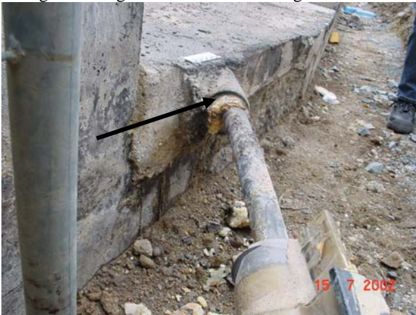
Bild 22 Kabel durch den Gefälleestrich gelegt, die gegenüberliegende Seite war auch offen, Das Ergebnis: 10 Jahre Wassereintritt in die Kellerräume!
