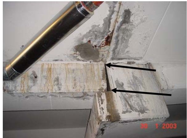
Bild 16 Verdrehung tragender Bauteile durch Schubspannungen infolge nicht ausgebildeter Gebäudedehnfugen
