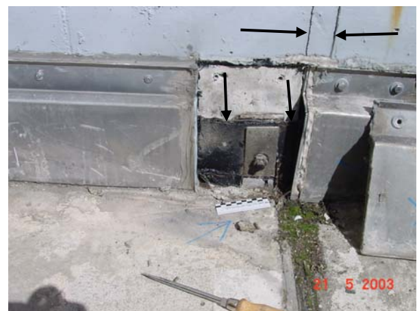
Bild 20 Dehnfugenaufkantung mit Los-/Festflansch, aber ohne oberseitigen Abdichtungsanschluss; das Formteil fehlt. Wasser dringt durch die abgerissene Versiegelung der Brüstung und der Trittschutzbleche hinter die Fuge. Das ist sowohl ein Ausführungs- als auch ein Bauleitungsfehler.
