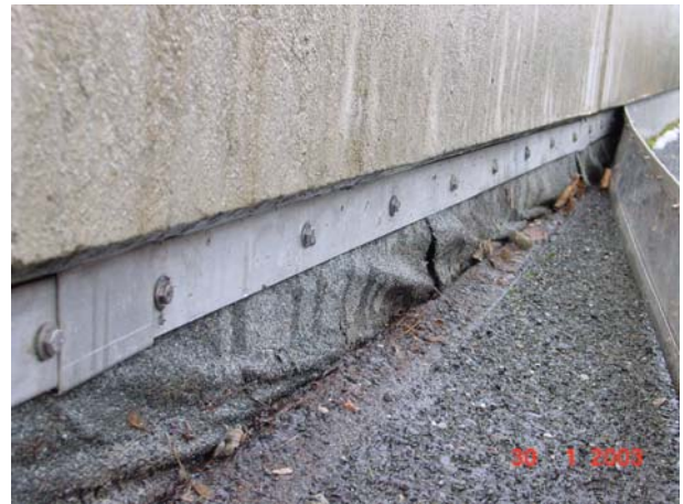
Bild 13 Schutzbeton mit Asphaltbelag auf Wärmedämmung – keine Fugenausbildung zur Brüstung, temperaturbedingte Längenänderungen drücken den Belag in die senkrechte Abdichtung – die Bewegungen des Belages reissen die Abdichtung ab
