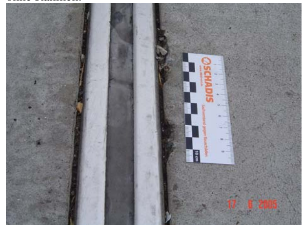
Bild 9 Kantenausbrüche, Der Metallrahmen ist nicht voll im Belag eingebettet. Es fragt sich, ob bei der Herstellung die Verfüllung und Verdichtung des Betons unter dem Profil überall gelingt, besonders in den Ecken.
