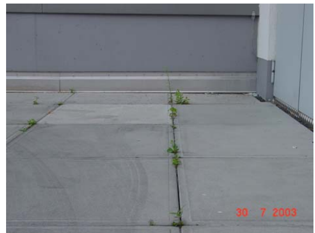
Bild 11 Bewuchs aus den Plattenfugen eines gefällelosen Parkdaches nach 2 Jahren. Das pflegt meist niemand. Wurzeln können nach einiger Zeit auch die Abdichtung durchwurzeln. Parkdächer werden kaum mit einer wurzelfesten Abdichtung geplant.
