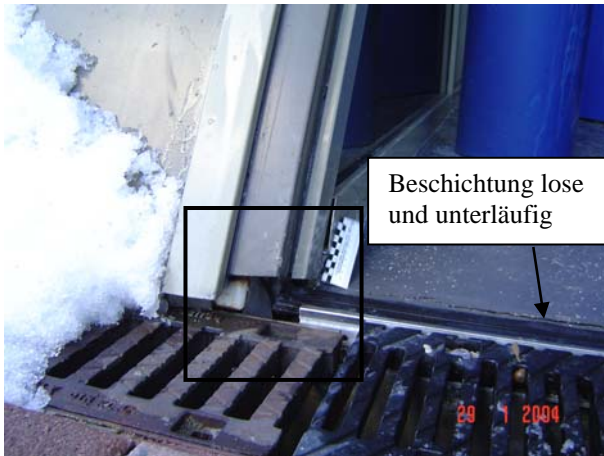
Bild 21 Detailausführung einer gepflasterten Hofkellerdecke auf Wärmedämmung, Anschluss an den Eingang mit Beschichtung und Fassade.
