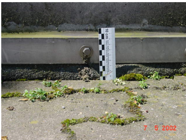
Bild 3 Pflasterbelag ohne Randfuge drückt in die Abdichtung; Schutz der Abdichtung fehlt; die Höhe der Abdichtung über OK Fahrbahnbelag muss 15 cm betragen, hier sind es nur 8 cm
