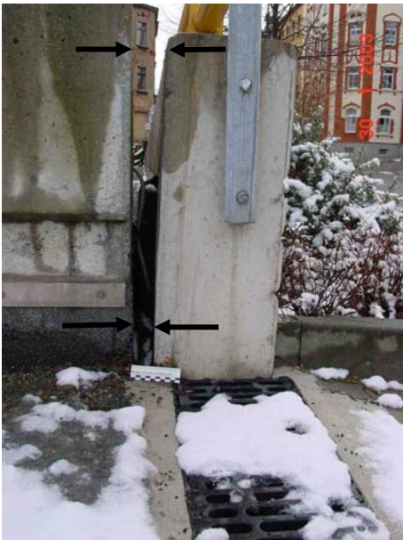
Bild 14 die Brüstung ist durch den Druck des Parkdachbelages nach aussen gedrückt
