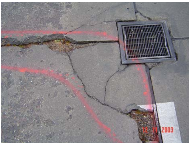
Bild 6 Kanten und Ecken abgebrochen
