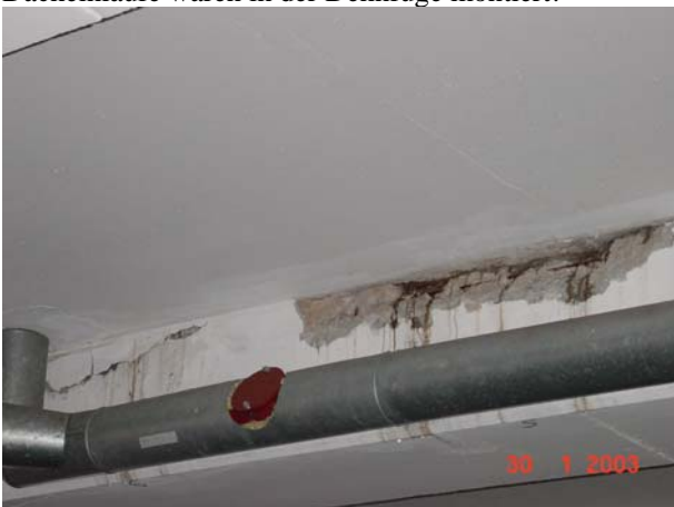
Bild 15 Betonabplatzungen an tragenden Bauteilen gefährden die Standsicherheit des Gebäudes
