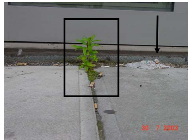
Bild 12 Bewuchs aus den Plattenfugen – im Hintergrund ein ungeschützter und nicht fixierter Abdichtungsanschluss, oberseitig lediglich „verspachtelt“
