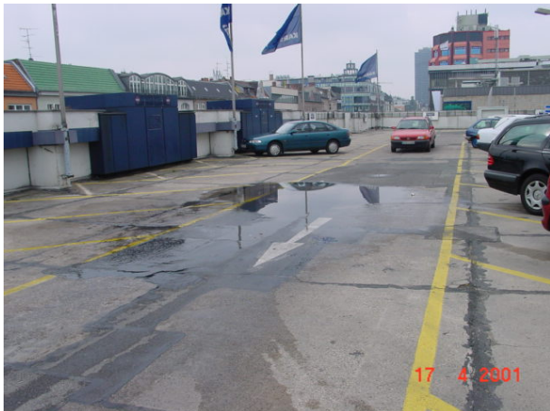
Bild 8 unzureichendes Gefälle führt zu Pfützenbildung, im Winter zu gefährlichen Eislinsen, schädigt die Konstruktion. In Parkplatzbereichen können die Kunden nicht mehr trockenen Fußes Ein- und aussteigen.
