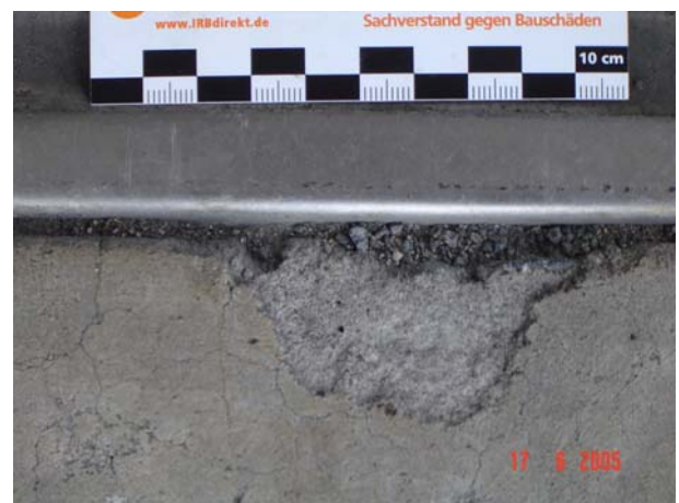
Bild 10 Kantenausbrüche und netzförmige Risse im Betonbelag, Wasser kann ungehindert hinter das Profil kriechen und bei Frost im Laufe der Jahre erheblichen Schaden anrichten. Der Belag ist erst 2 Jahre alt!
